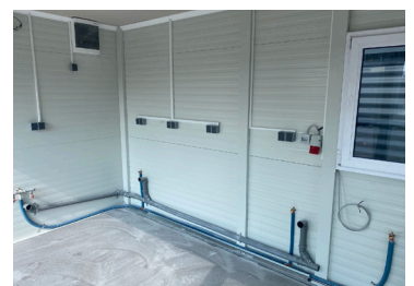
nadomestna instalacija raznih dodatkov
